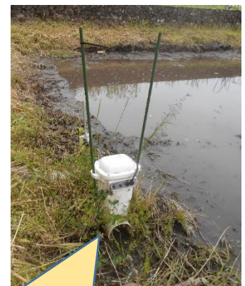
水を管理する「自動水門」
